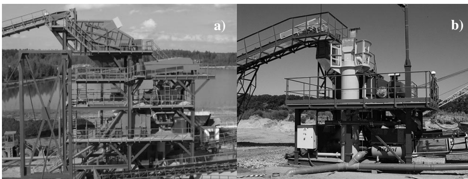
Rys. 6. Klasyfikator K-100 w Borzęcinie (a) i Januszkowicach (b) [3, 4] Fig. 6. K-100 pulsatory jig in Borzęcin (a) and Januszkowice (b) [3, 4]
